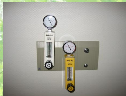
➤ 医療ガス保守点検
